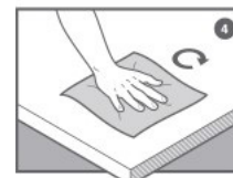
Spülen Sie die reparierte Stelle mit lauwarmem Wasser und einem Mikrofasertuch ab.
